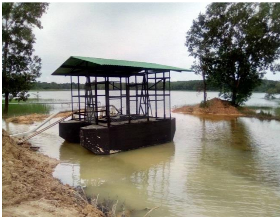
เครื่องสูบน้ำบริเวณอ่างเก็บน้ำหนองอ่างปลา
